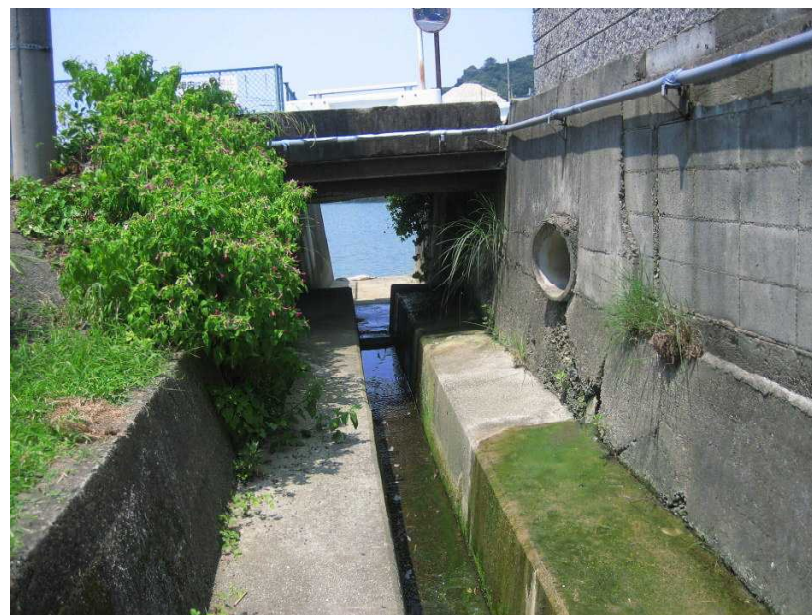
崩壊の危険性を指摘した浜代川に架かる橋
