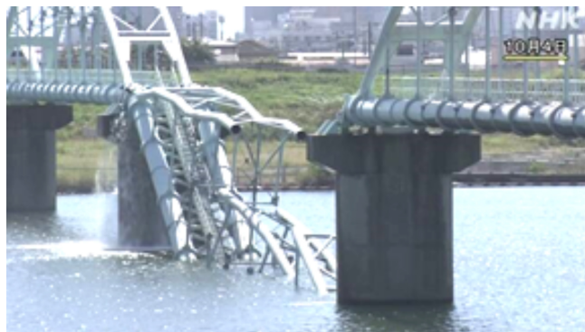
崩落した六十谷水管橋 (写真はNHKニュースより)
