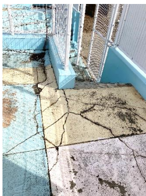
ひび割れたプールサイドの床
